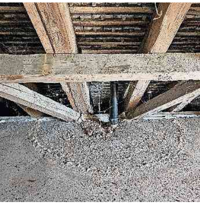
Feuchtigkeit im Dachstock
