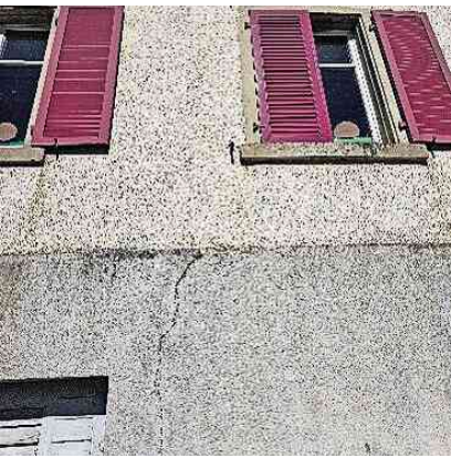
Risse in der Fassade
